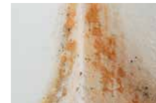
Schimmel durch schlecht gedämmte Fassaden
